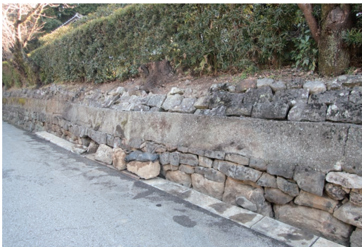
高知公園西ノ丸西側石垣崩落箇所風景（南西より）
